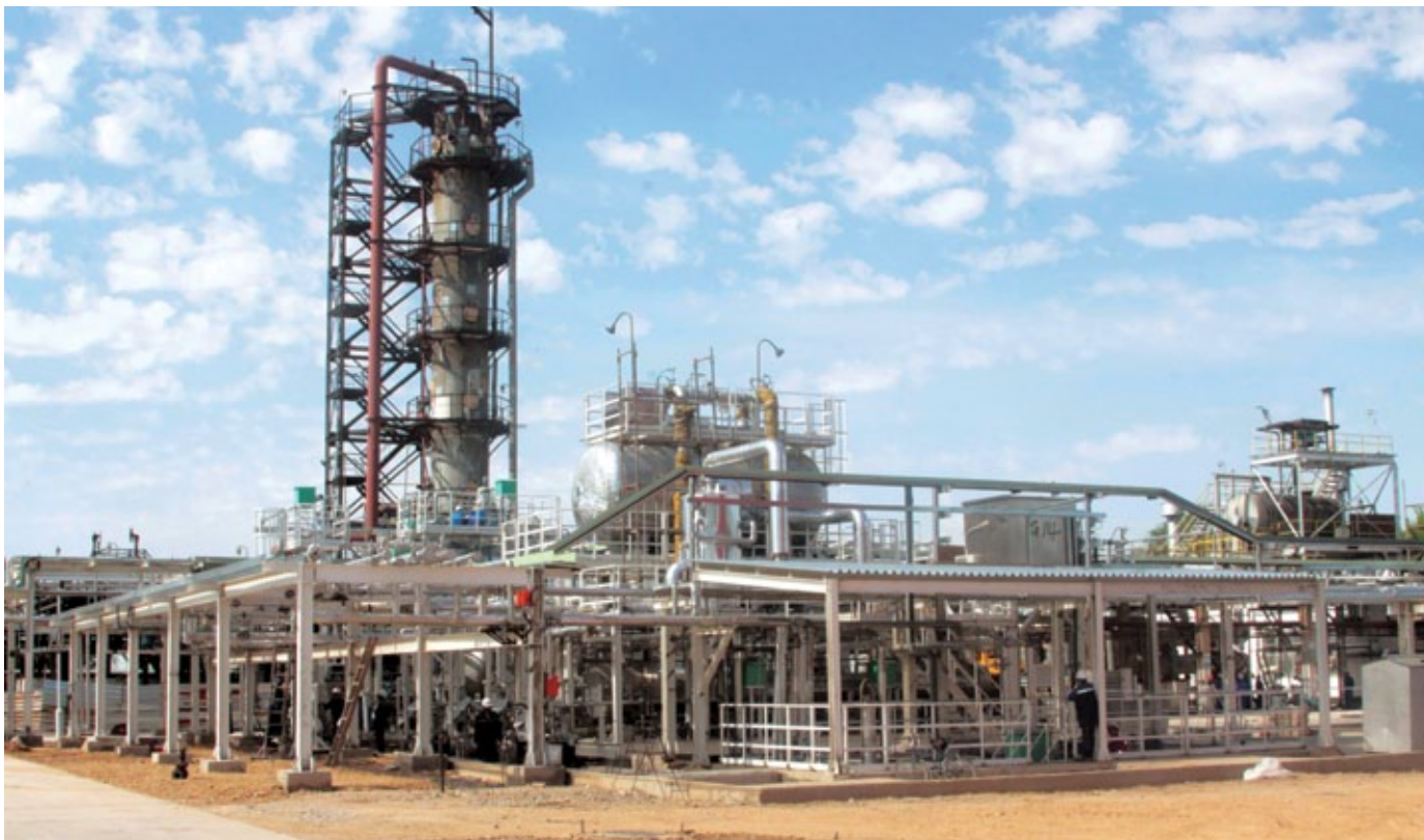
МЭА (моноэтанолamina) регенерациялау және күкірт алу қондырғысы, №2 цех, 2014 / Установка регенерации МЭА (моноэтанолamina) и производства серы, цех №2, 2014 / Monoethanolamine (MEA) Distillation and Sulphur Production Unit, Workshop No.2, 2014
