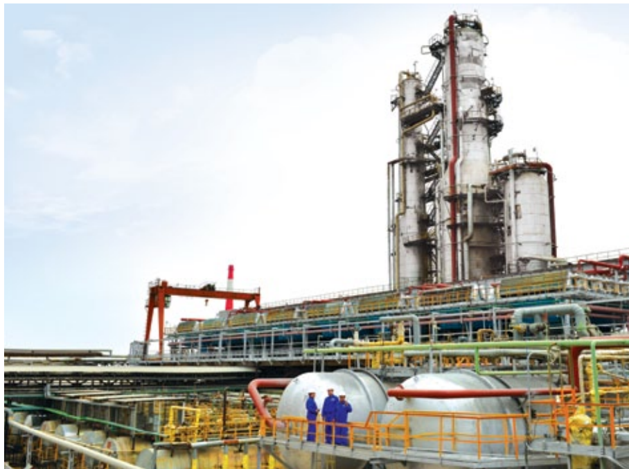
ЭЛТҚ-АҚ (мұнайды атмосфералық айдау және электрмен тұзсыздандыру қондырғысы) ЛК-6У қондырғысының 100 секциясы / ЭЛОУ-АТ (электрообессоливающая установка атмосферной перегонки), секция 100, установка ЛК-6У / CDU (Crude Distillation Unit) Unit-100, LK-6U
