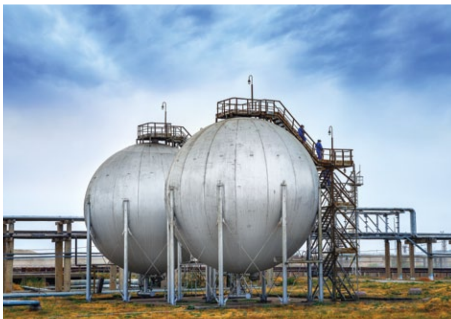
БСАЖ (бумен, сумен, ауамен жабдықтау) цехының азотты-оттекті станциясы / Азотно-кислородная станция, ПВВС (пароводовоздушоснабжение) / Air-Nitrogen Plant, Utilities Workshop
