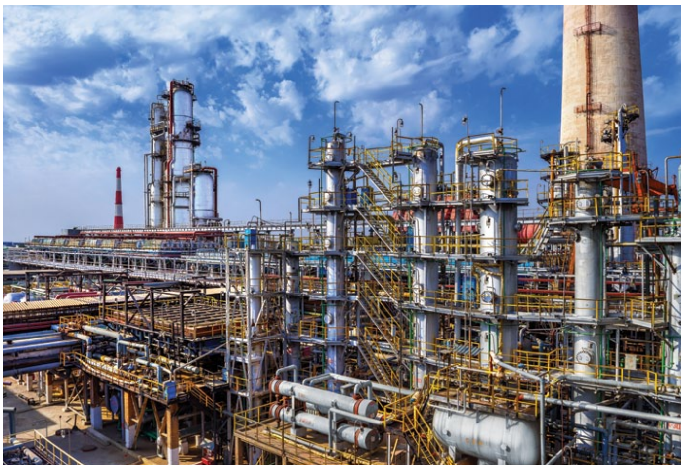
ЛК-6У кешенді қондырғысының 400 секциясы - ГФҚ (газды фракциялау қондырғысы), 2014 / Установка ГФУ (газофракционирование), секция 400, установка ЛК-6У, 2014 / GFU (Gas Fractionation Unit), Unit-400, LK-6U, 2014
