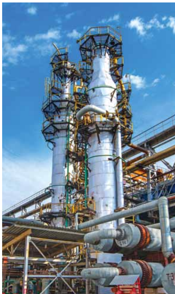
300-секциясының гидротазалау және гидропарафинсіздендіру колонналарының блогі / Блок колонн гидроочистки и гидродепарафинизации, секция 300 / Hydrotreatment and hydrodewaxing columns, Unit-300
