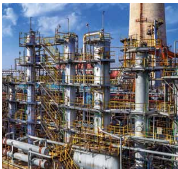
400-секциясы - ГФК (газды фракциялау кондырғысы) / Установка ГФУ (газодифракционирование), секция 400 / GFU (Gas Fractionation Unit), Unit-400
