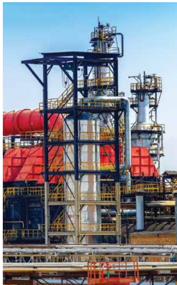
301/1 секциясының Р-301-1 жаңа реакторы / Новый реактор Р-301-1, секция 301/1 / New R-301-1 reactor at Unit-301/1
