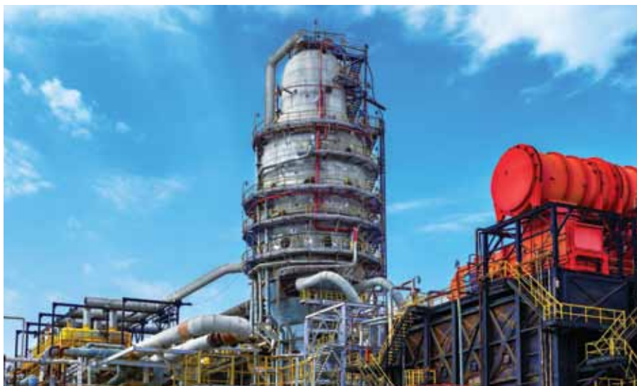
МБАК (мазутты вакуумды айдау кондырғысы) вакуум колоннасы, №2 цех / Вакуумная колонна УВПМ (установка вакуумной перегонки мазута), цех №2 / Vacuum column of VDU (Vacuum Distillation Unit), Workshop #2
