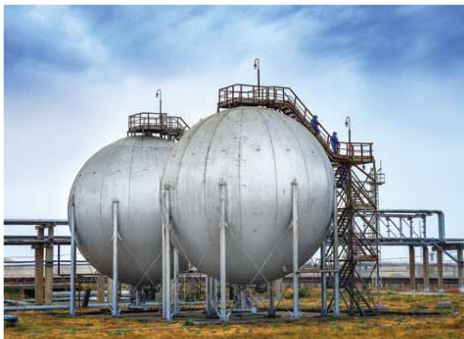
БСАЖ цехының азотты-оттекті станциясы / Азотно-кислородная станция, ПБВС / Air-Nitrogen Plant, Utilities Workshop
